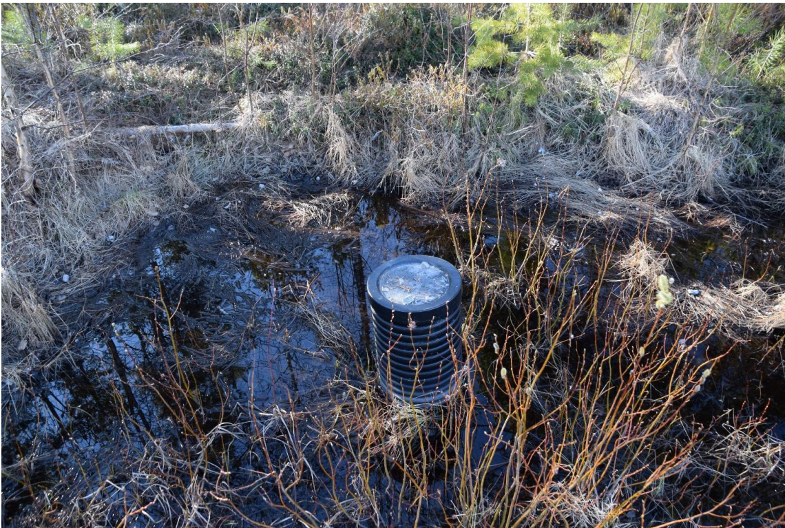
Kuva. Setolkka -kadun varren tarkistuskaivo.
