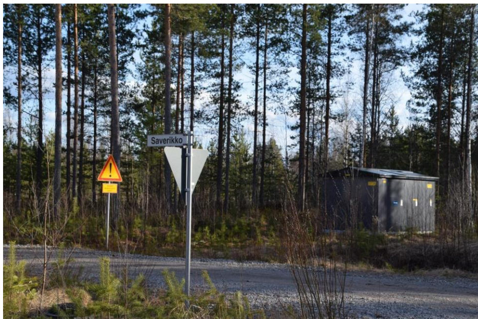
Kuva. Puistomuuntaja Saverikon ja Isosuontien risteyksessä.
