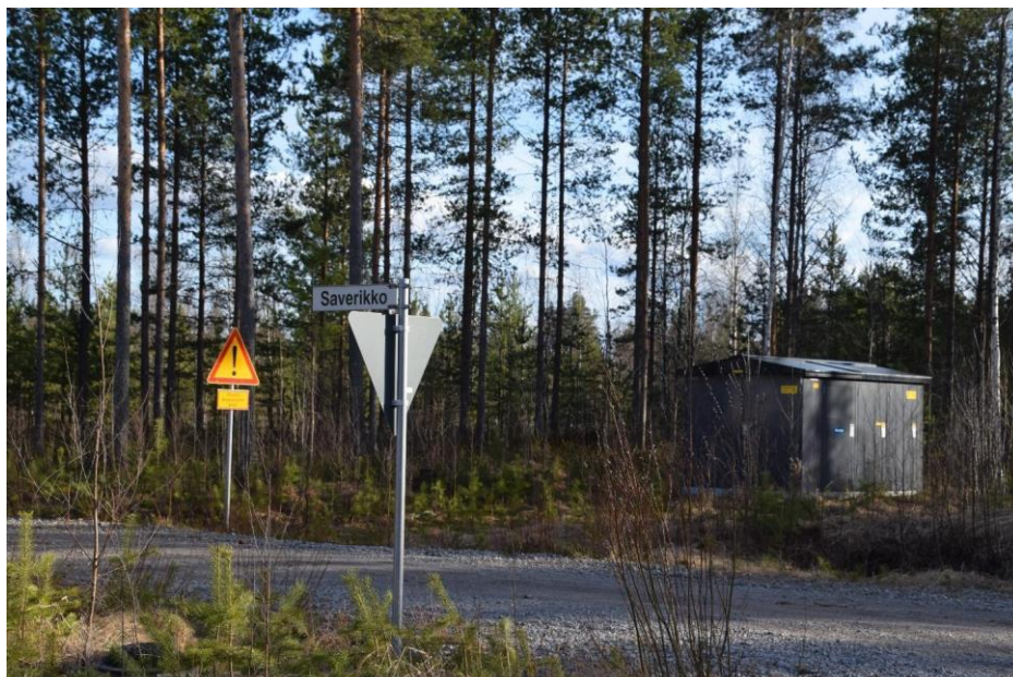
Kuva. Puistomuuntaja Saverikon ja Isosuontien risteyksessä.
